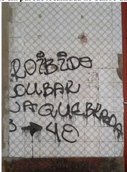
Figura 4 – Pixo em parede localizada no bairro da Praia Grande
